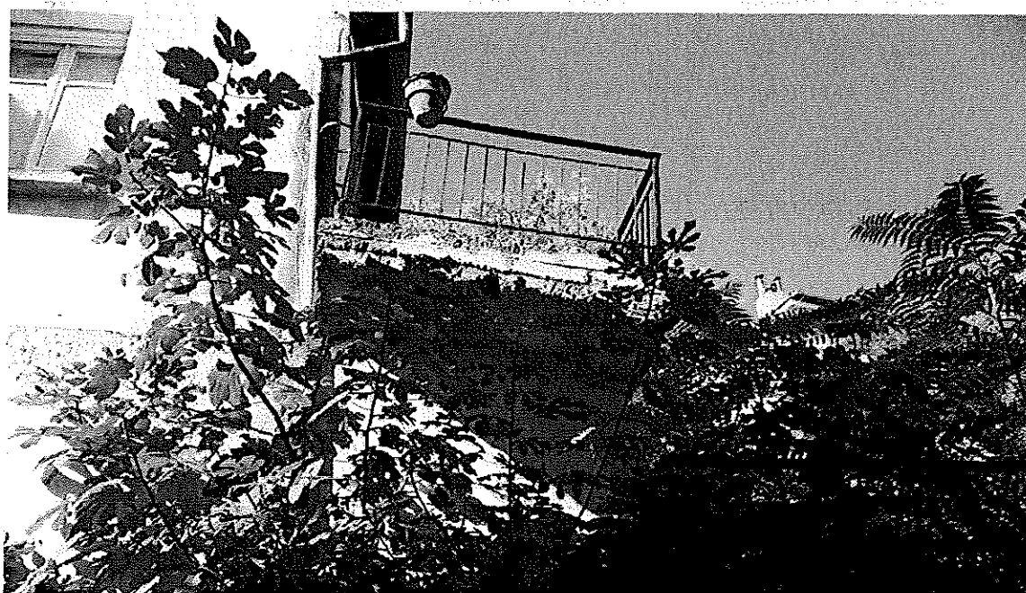
Φωτ. 11 Απόκλιση από την οριζόντιο του εξώστη από σκυρόδεμα
