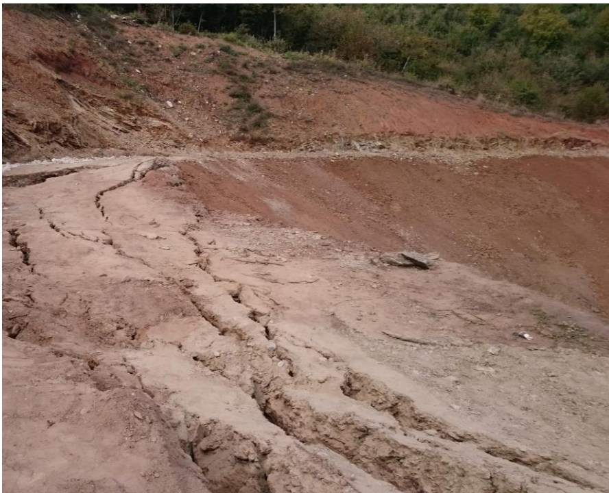
Φωτ 1.2: Άποψη της διανοιγμένης χωμάτινης οδοποιίας, όπου διακρίνεται η εκτεταμένη παραμόρφωση του υποβάθρου και οι εφελκυστικές ρωγμές που προκλήθηκαν από το φαινόμενο της ολίσθησης.
