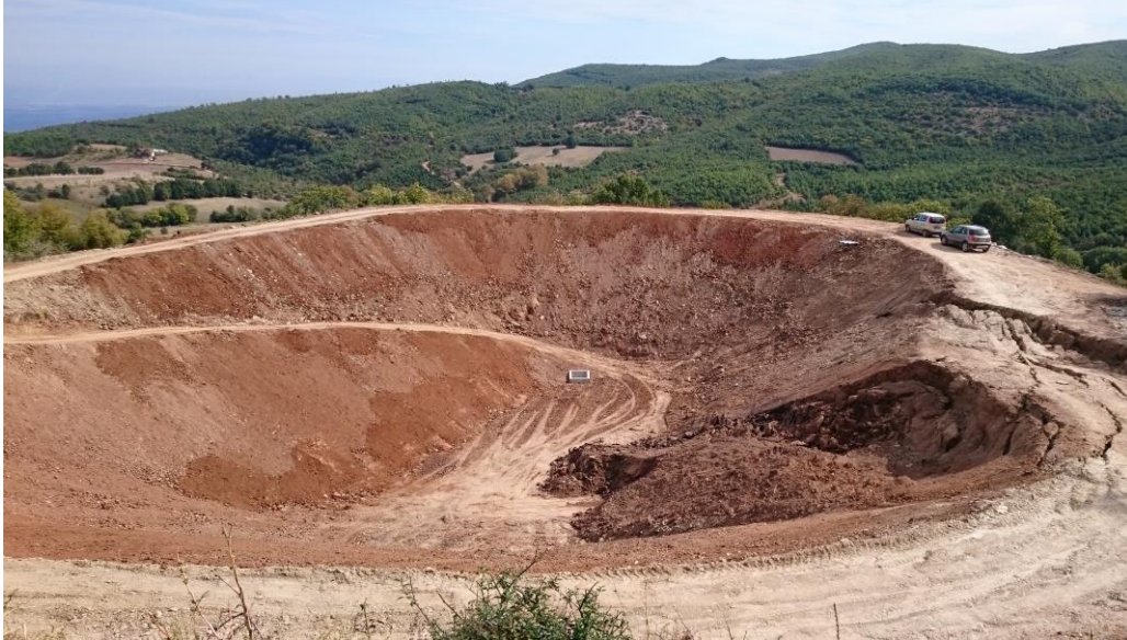
Φωτ 1.1: Άποψη της λιμνοδεξαμενής, όπου εμφανίζεται το κατολισθένον πρανές.
