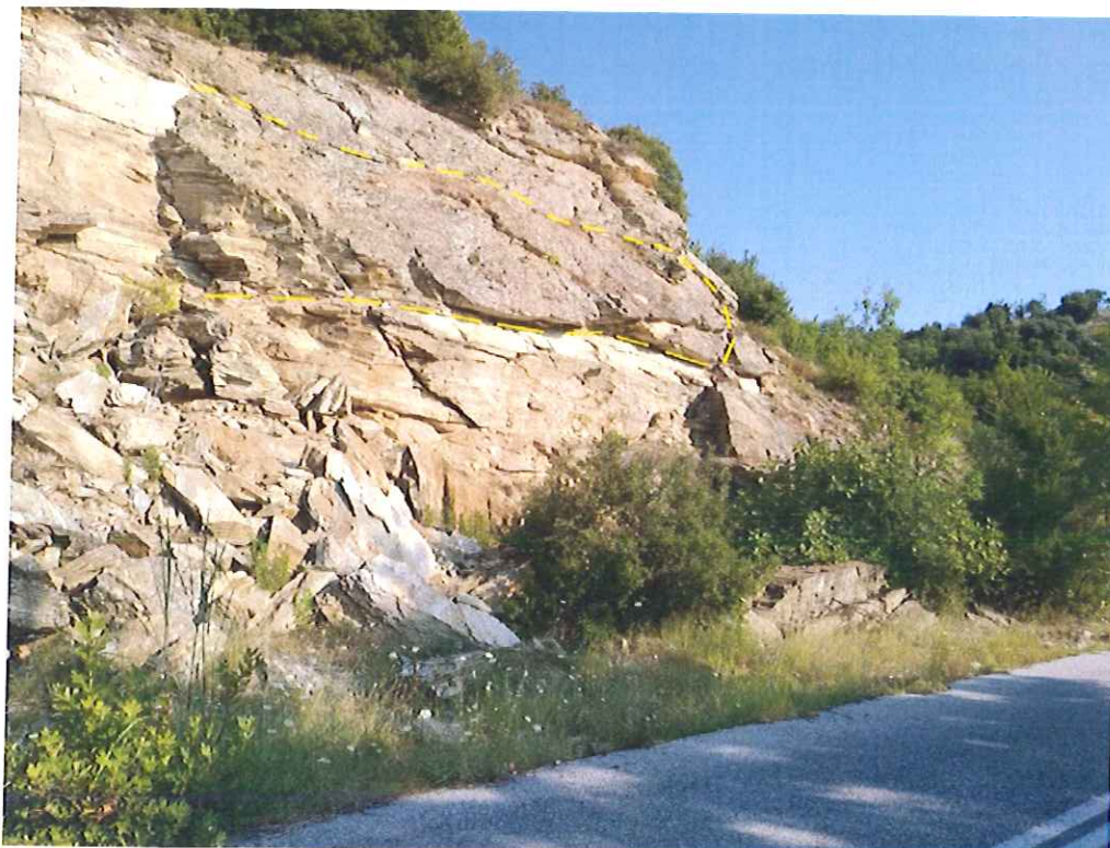
Εικόνα 10.: Μεγάλο κομμάτι βραχομάζας με σημάδια αποκόλλησης και εμφανή τον κίνδυνο πτώσης με ανατροπή.
