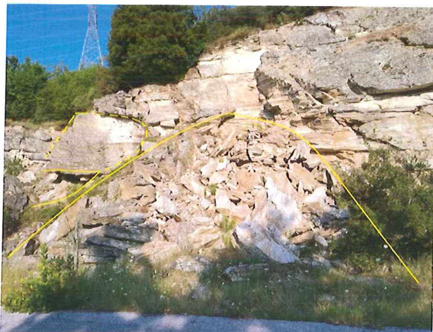
Εικόνα 11.: Μεγάλο αποκολλημένο τέμαχος με εμφανή σημάδια υποσκαφής και κίνδυνο πτώσης με ανατροπή, καθώς επίσης και σχηματισμένος κώνος κορημάτων.
