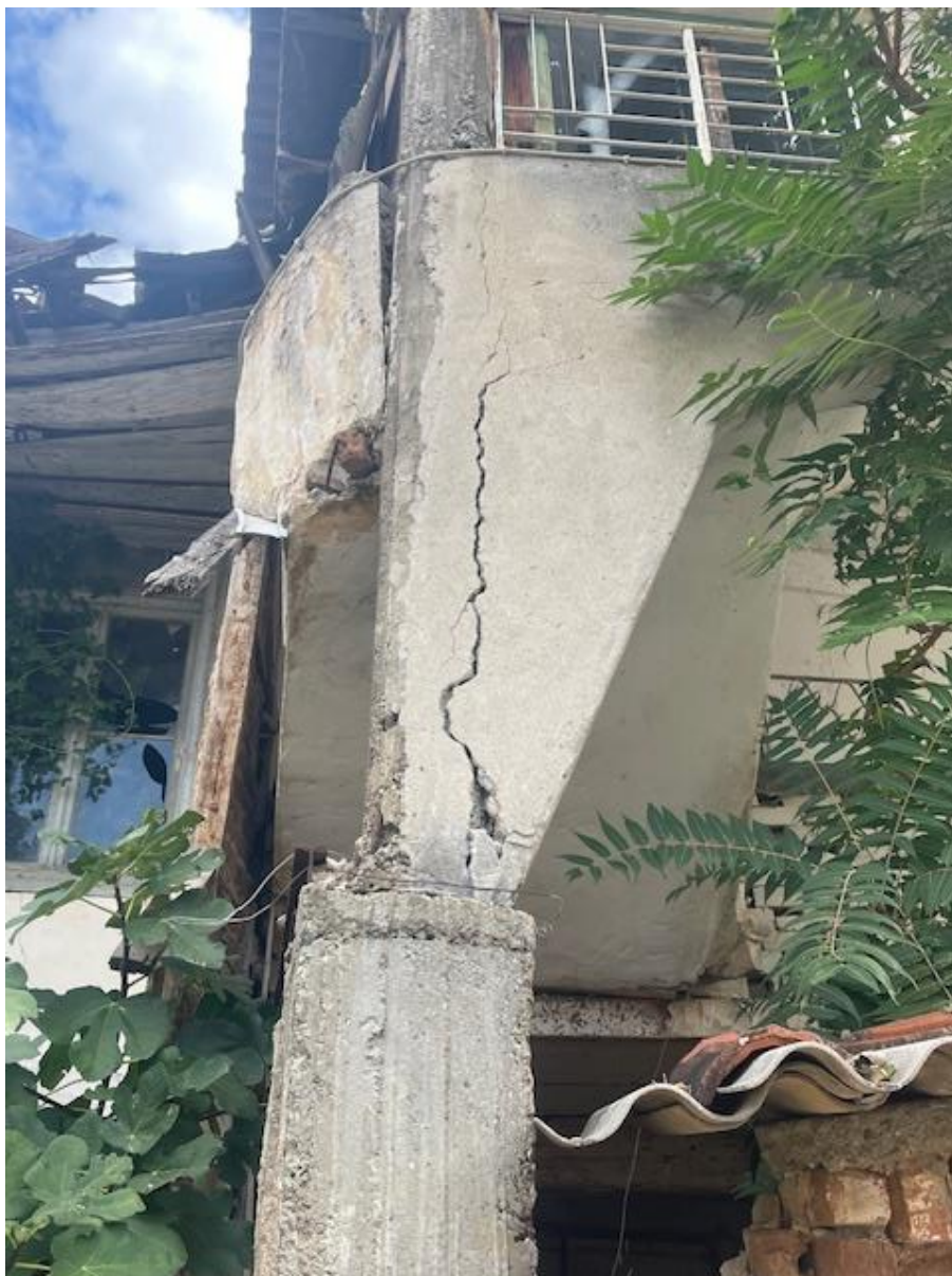
Φωτ 2 Γωνιακό υποστύλωμα στήριξης ορόφου με εμφανή την διαμήκη κατακόρυφη ρωγμή και την ασυνέχεια του στατικού φορέα (μη ενιαίο φέρον στοιχείο).
